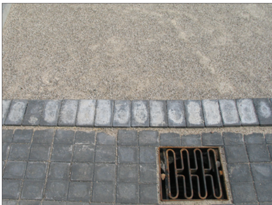
Kraftige kalkudfældninger på sorte sten. Er sådanne udfældninger tilstede ved lægningen, skal leverandøren kontaktes for at aftale det videre forløb.
