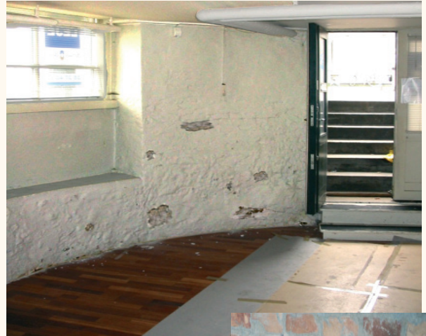
Fugt og saltskadedet væg
